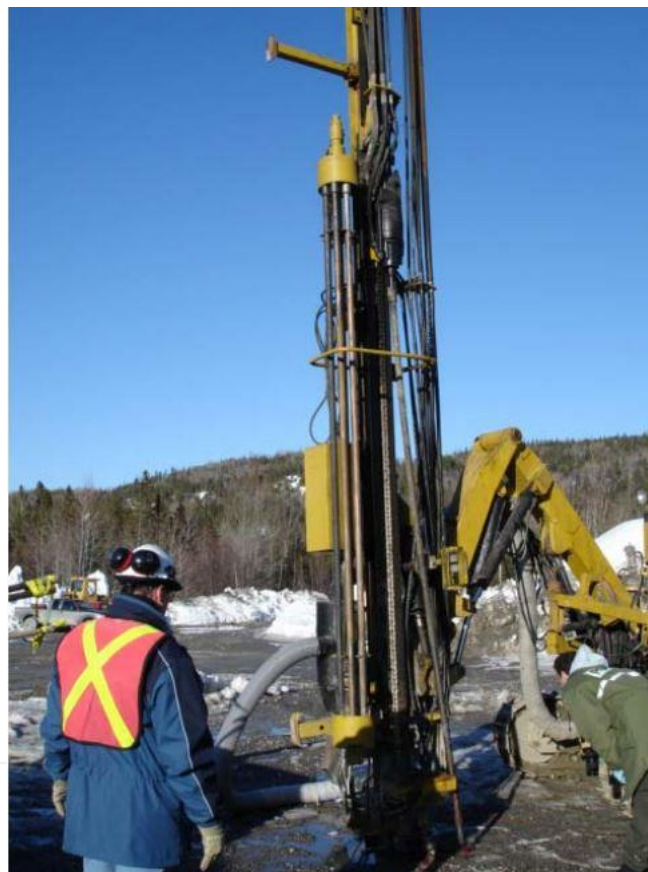
Râtelier de distribution et tiges de forage (source : CSST)
