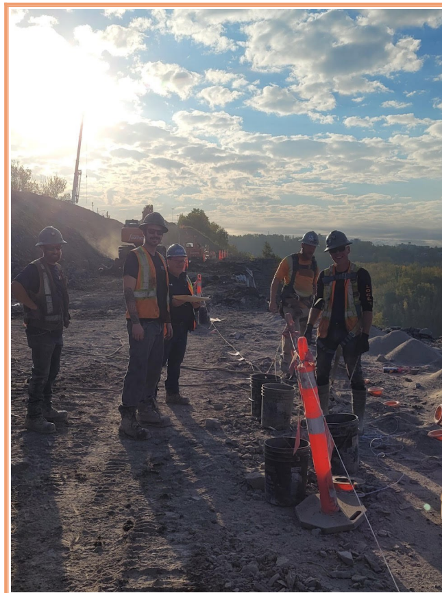
Ville de Montréal, construction d'un quai continu, carrière St-Michel, photo courtoisie Étienne Bibeau.
