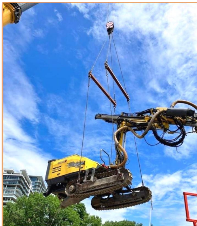
Station de pompage St-Étienne à Gatineau
