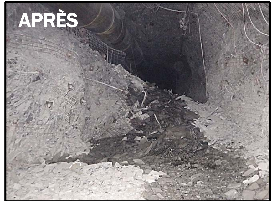
Figure 5 : Excavation suite à un coup de terrain dans une mine québécoise (tiré de Morissette, 2017)
