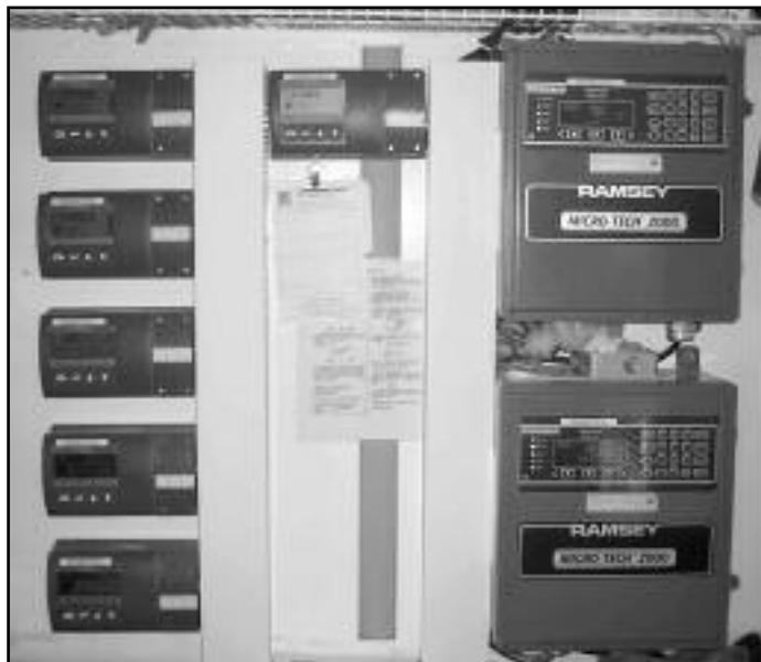
Figure 5 : Intégrateurs de balance à courroie utilisés pour afficher le taux de tonnage et le tonnage cumulé.
